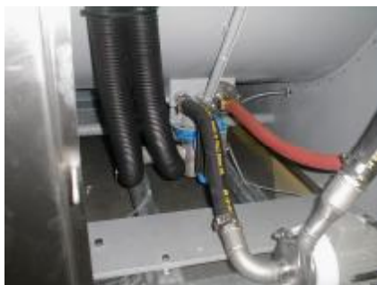
Ansicht Abfluss und Rückgewinnungspumpe
